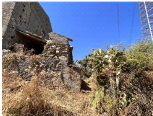
Vista dalla strada interpoderale - crollo parziale avancorpo al piano terra
